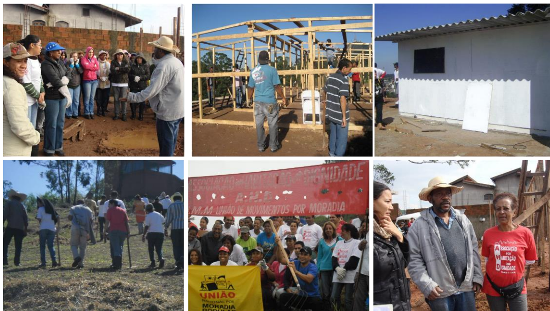
Fotos 53 a 58 – Mutirão da construção da casa do caseiro do Movimento A.H.D (2012)
