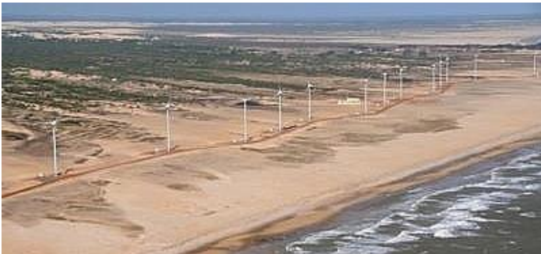
Foto 4: Primeira Etapa do Parque Eólico da Pedra do Sal. Autor: Zig Koch, 2012. Fonte: < http://www.naturezabrasileira.com.br/foto/18866/usina_eolica_pedra_do_sal_pi.aspx >. Acesso em: 27 jun. 2015.
