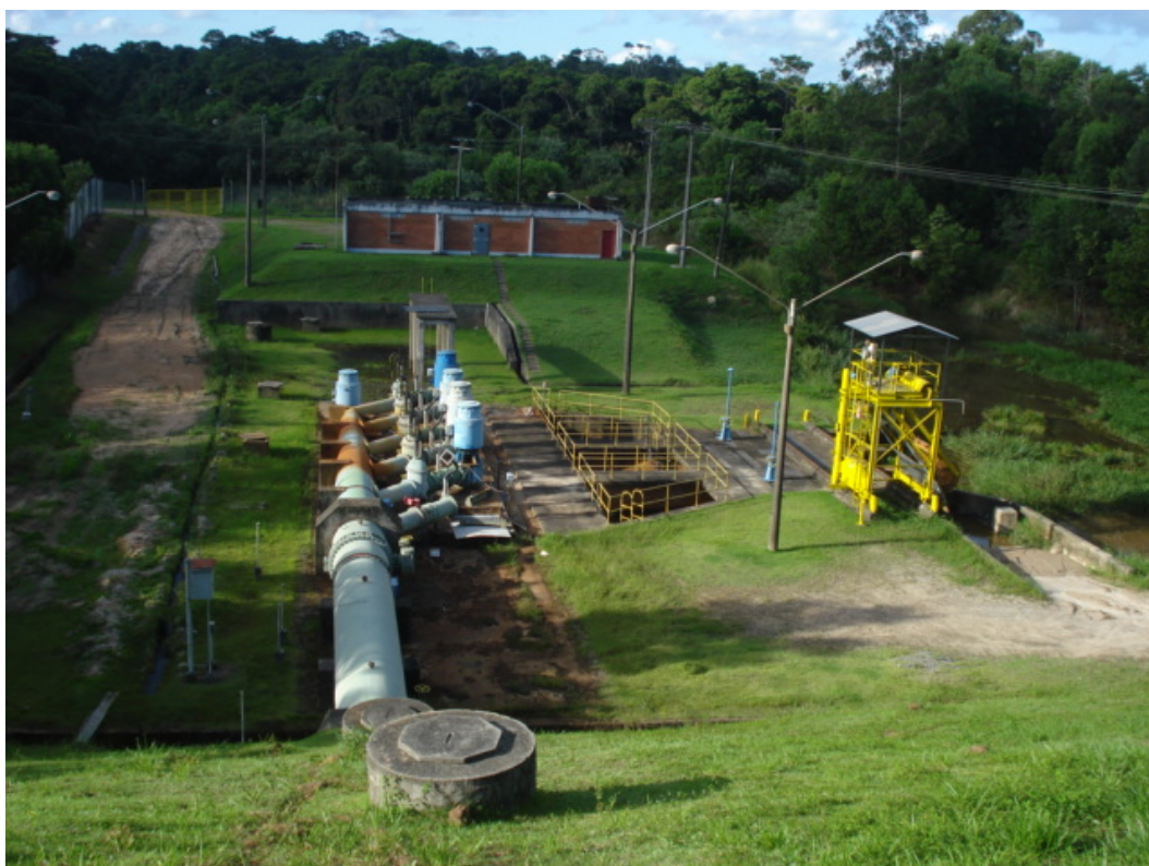
Foto 27: Sistema de bombeamento para inversão do Rio Gimuhuna. FONTE: Acervo pessoal.
