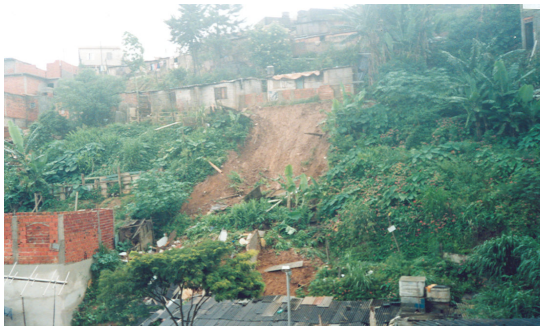
FIGURA 30 - NH Marilene: Desmoronamento por risco geotécnico
