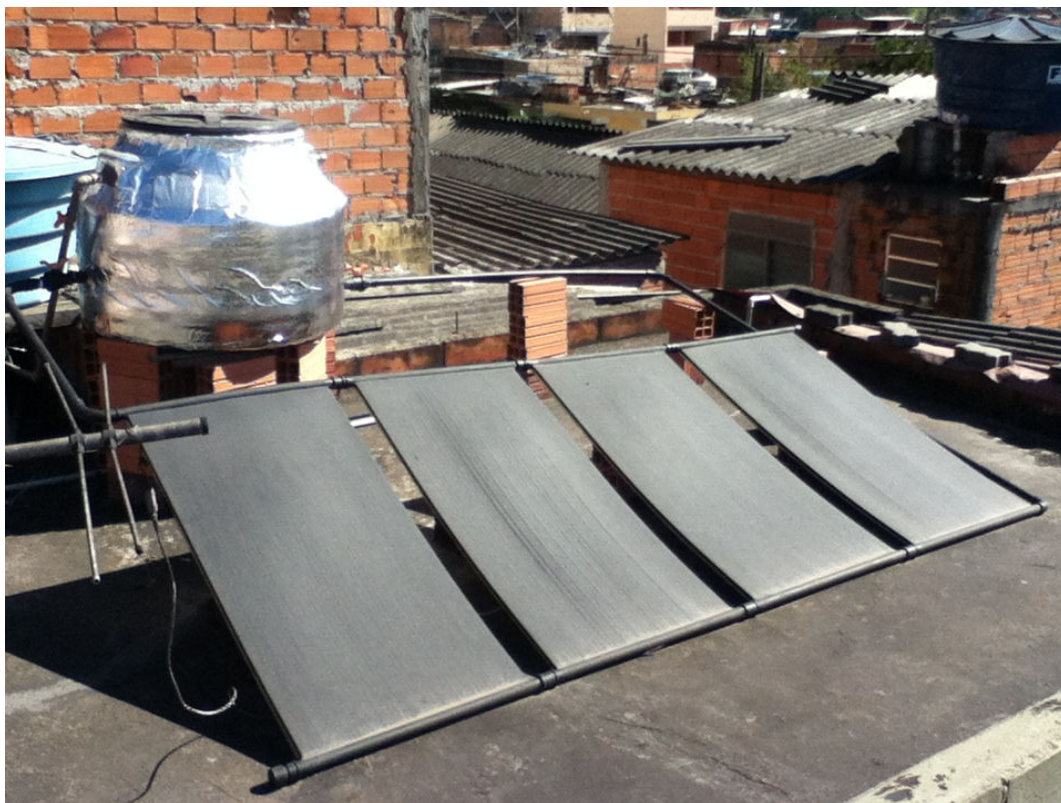
Reservatório de água revestido de manta térmica e placas solares
