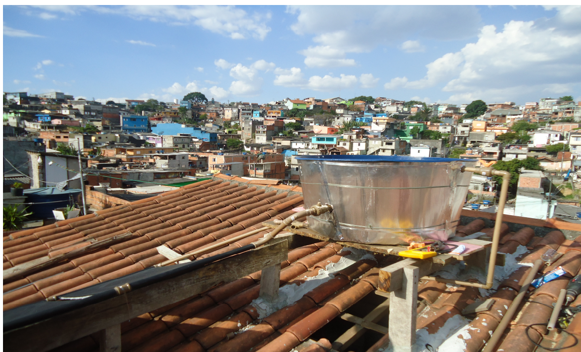
Caixa-d'água revestida com isolante térmico
