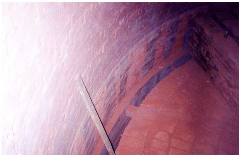
Foto 25. No primeiro plano está o vão de 15 centímetros pelo qual o calor passa, vai para os canais, chega à abobrinha , e daí para a chaminé. Autor: Roberto Massei. Fonte: Acervo do autor. Data: 20 dez. 2006.
