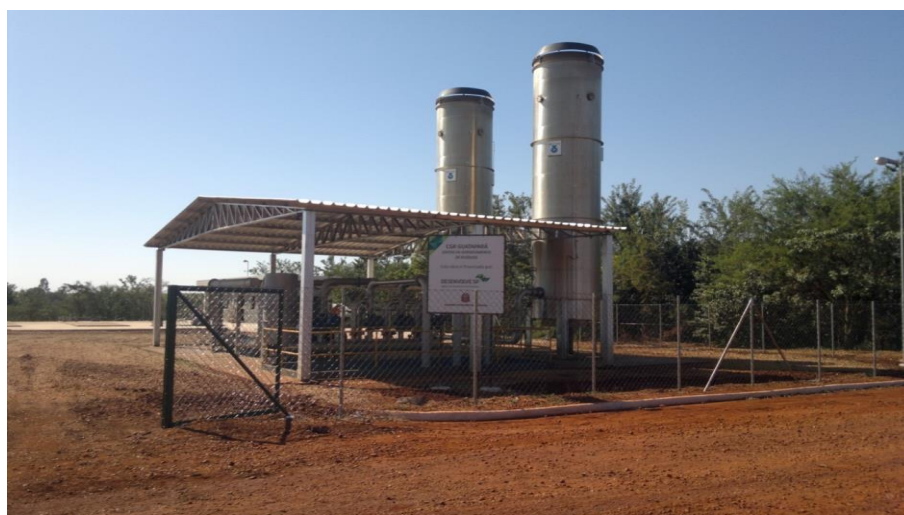
Foto 8 - Sistema de queima de gases CGR-Guatapar
