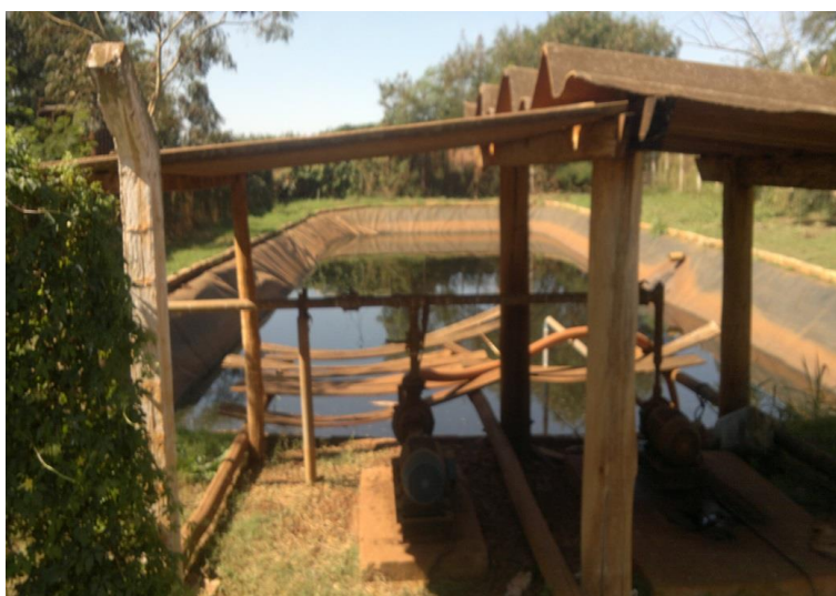
Foto 1 - Área de coleta e bombeamento do chorume
