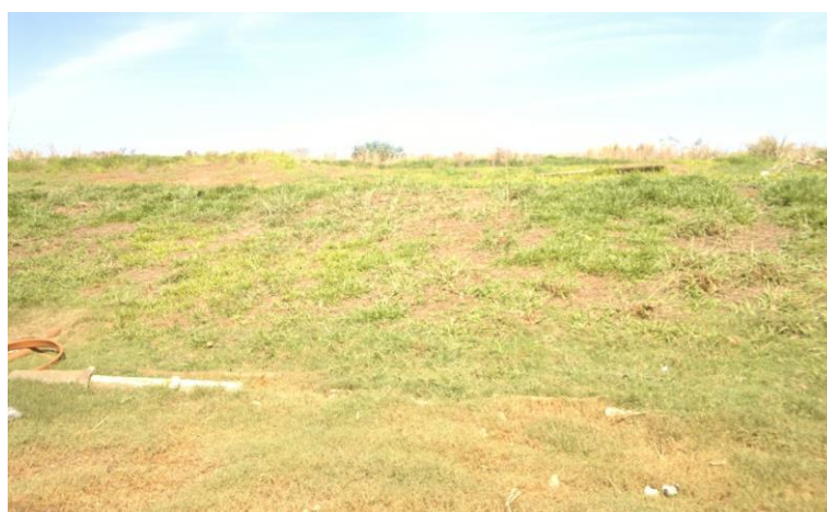
Foto 3 - Área do antigo aterro coberta com terra e cano de coleta de chorume
